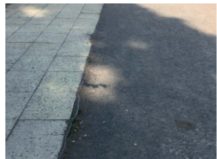
Abb. 46: Schäden an Stahlkante
