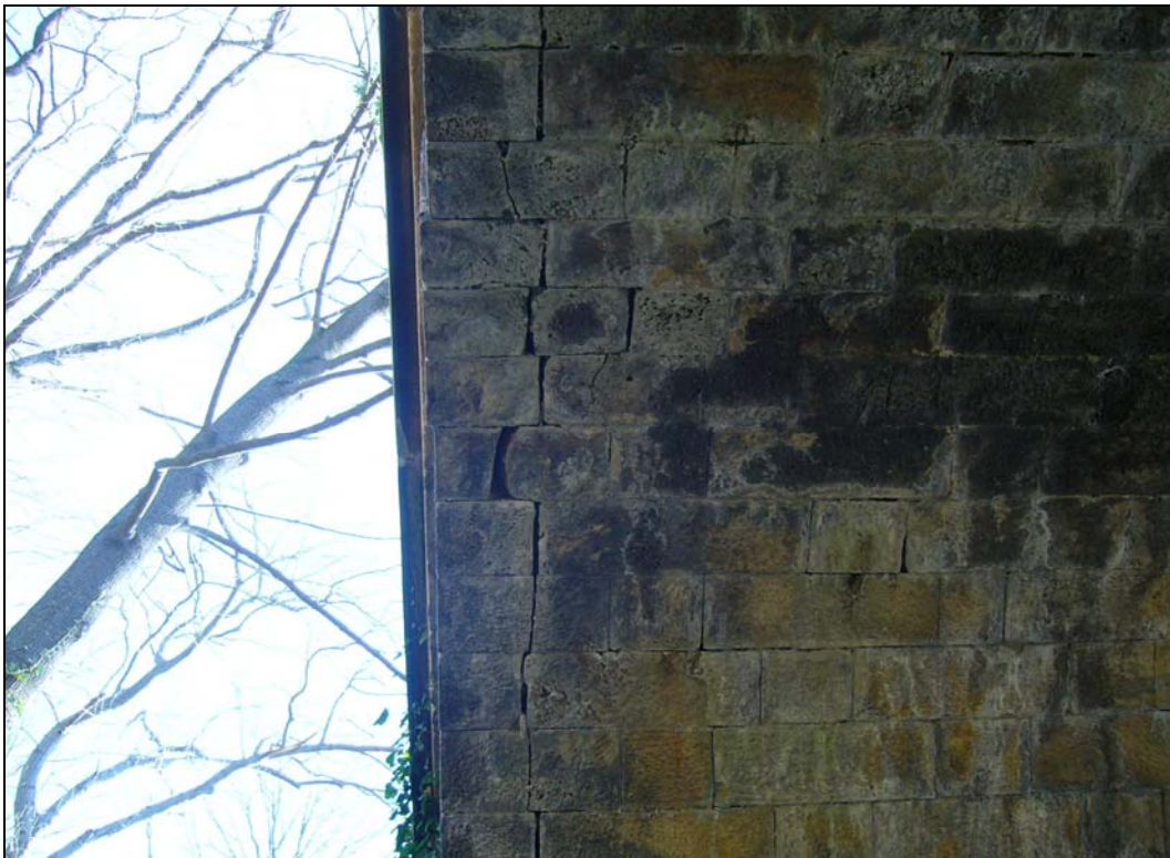
Abb. 7: Stirnringriss im 6. Brückenbogen, Blick von unten, Foto: Klingner März 2008.
