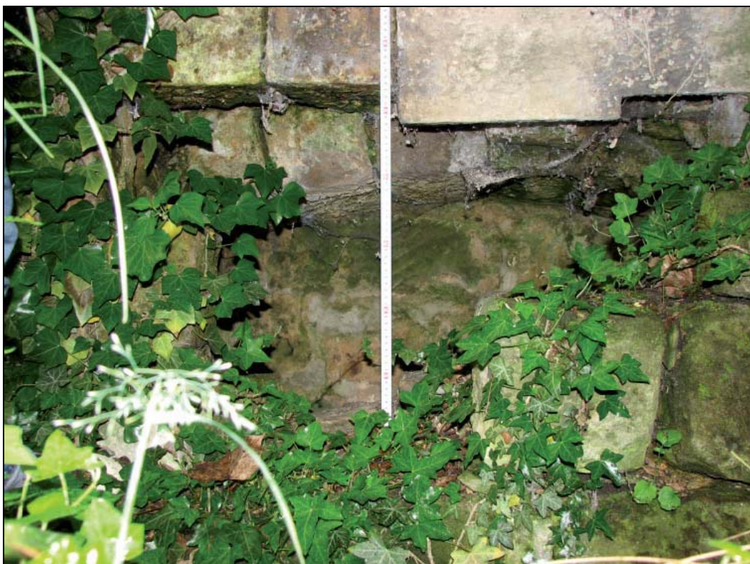
Abb. 23: Loch im Verblendmauerwerk der Mauer A, Blick von Süden, Foto: Henning April 2008.
