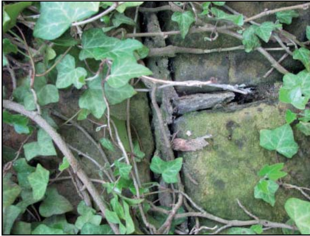
Abb. 25: Mauer C, Efeubewuchs, Mörtelverlust in den Fugen, Foto: Henning April 2008.
