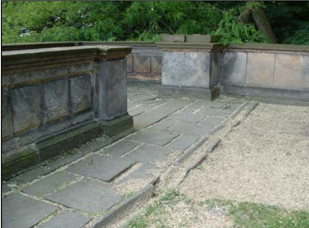
Abb. 40: Treppenpodest, schadhafte Rinne, Blick von Nordosten, Foto: Shyu April 2008.
