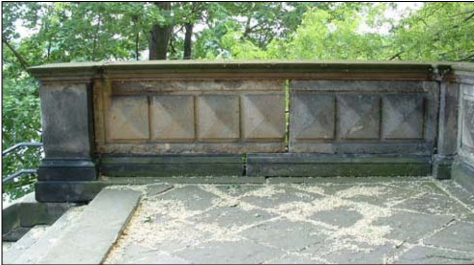
Abb. 36: Treppenpodest, offene Fugen in der Brüstung, Foto: Shyu April 2008.
