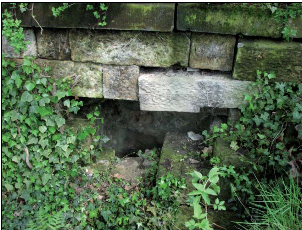
Abb. 22: Loch im Verblendmauerwerk der Mauer A, Blick von schräg oben, Foto: Henning April 2008.
