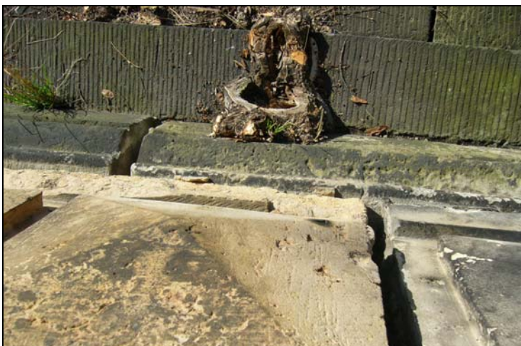
Abb. 37: Treppenpodest, Wurzelstock auf dem äußeren Brüstungsrand, Blick von oben, Foto: Klingner März 2008.
