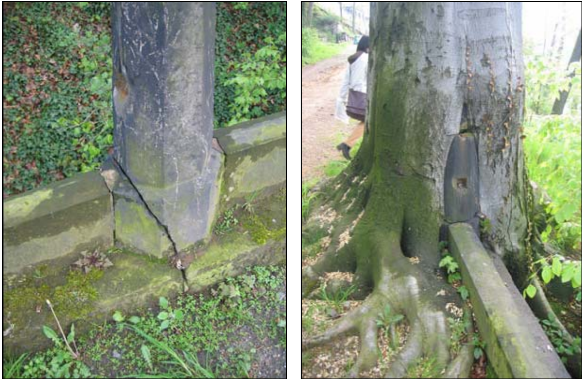
Abb. 49: rechts: mittlerer Brückenpfosten der Nordwand, Riss in der Basis, rechts: eingewachsene Pfosten an der Nordwand der Brücke, Fotos: Seidel/ Shyu April 2008.
