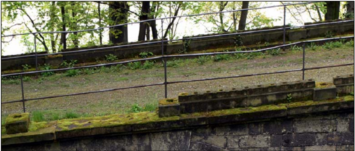
Abb. 5: Fahrbahn mit Brüstungsresten auf dem Viadukt, Blick von Norden, Foto: Blask/Edelmann April 2008.
