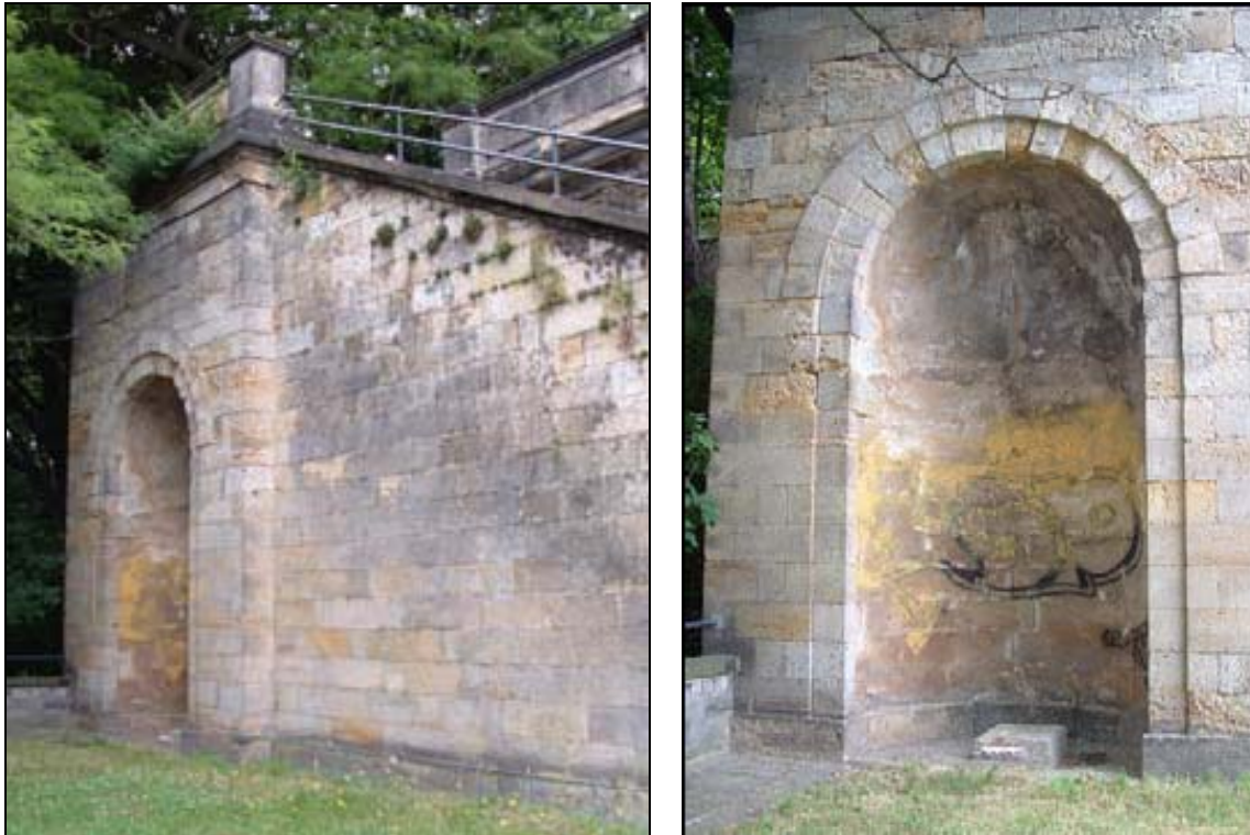
Abb. 35: Halbrundnische unter dem Treppenpodest, links: Blick von Südosten auf die Halbrundnische unter dem Podest, rechts: Blick von Süden, im oberen Teil des Gewölbes sind Auswaschungen zuerkennen. Foto: Shyu April 2008.
