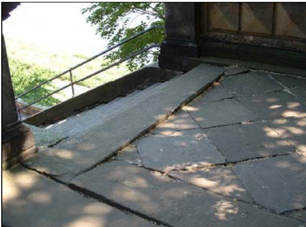
Abb. 39: Treppenpodest, Absenkung des Plattenbelages vor der Treppe, Foto: Shyu April 2008.
