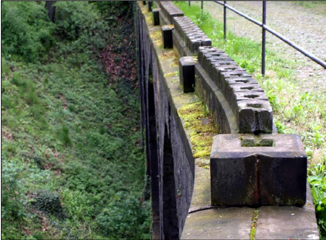
Abb. 6: Südliche Stirnwand des Viaduktes: Die Wand neigt sich leicht nach außen. Foto: Blask/ Edelmann April 2008.
