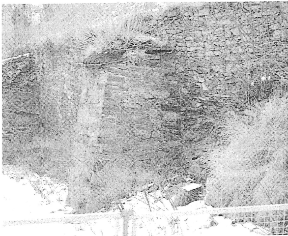
Abbildung 4.1.2: Schäden durch Bewuchs
