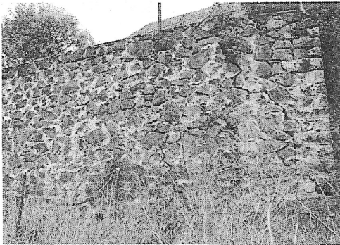
Abbildung 5.6.1: Ansicht der schadhaften Stützmauer
