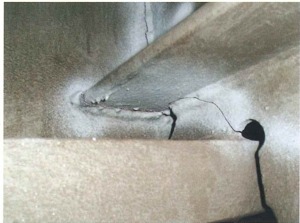
Bild 11.5: Gerissene Rahmenecke (Quelle: Straßen.NRW)
