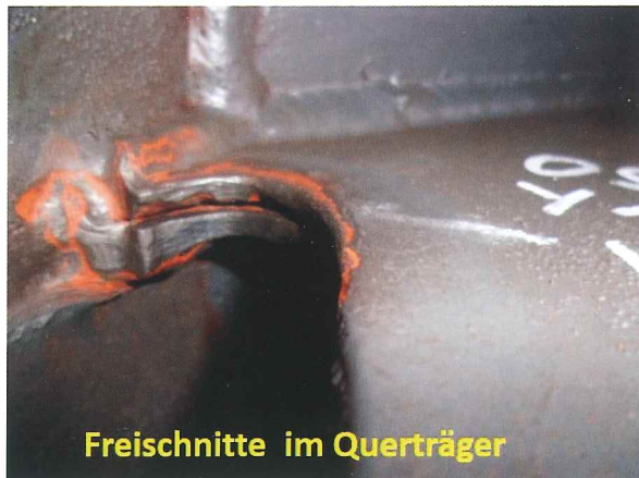
Bild 11.12: Aufreißung in Blechmitte (Quelle: IWT Aachen)
