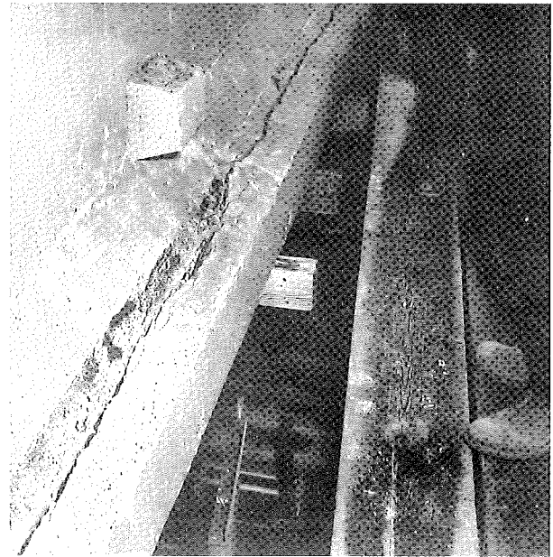
Bild 8.14: Längsriß am unteren Flansch bei einem der Träger
