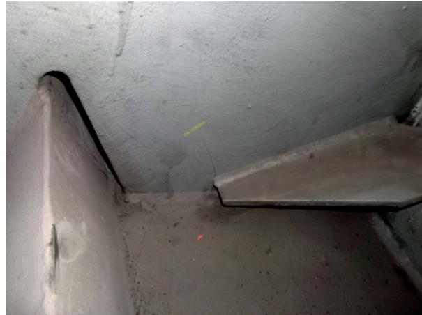
Bild 11.4: Riss an einer Lasteinleitungssteife an einer Schrägstrebe (Quelle: PSP Aachen)
