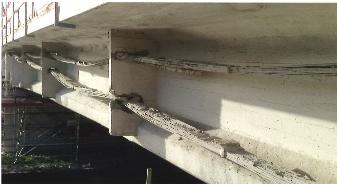
Bild 8.19: Freigelegte Spannglieder bei einem seitlichen Längsträger (Foto: Luc Taerwe)
