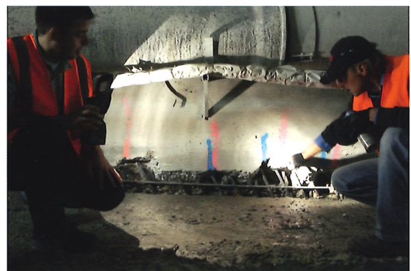
Bild 17.7: Kochertalbrücke, Spanngliedlage Planung (rot) und Ist-Zustand (blau) (Foto: Sebastian Wilhelm)
