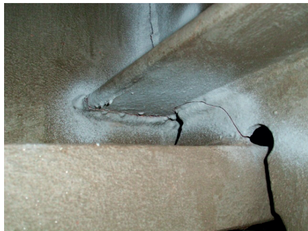
Bild 11.5: Gerissene Rahmenecke (Quelle: Straßen.NRW)
