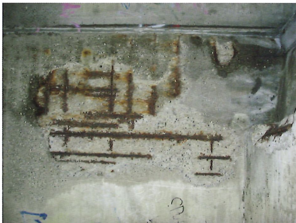
Bild 14.9: Bewehrungskorrosion unter einer Autobahnbrücke der A 661 bei Frankfurt (Foto: Karl-Heinz Wellmann)
