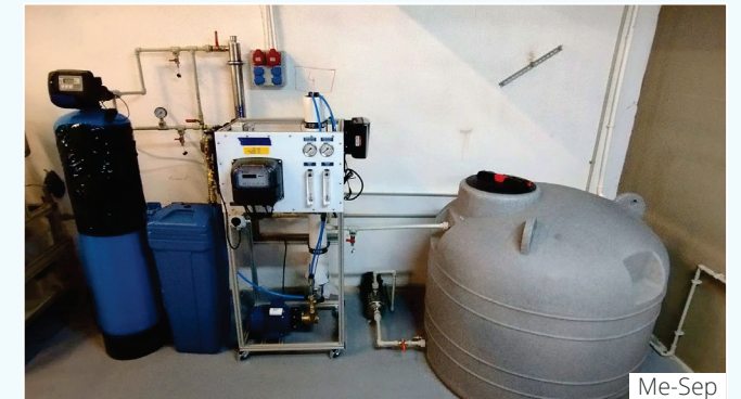
Pilotversuche zur weitergehenden Aufbereitung
