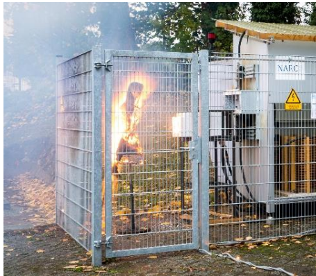
Bild 2: Test-Dummy ohne Arbeitsschutzkleidung nach Lichtbogeneinwirkung
