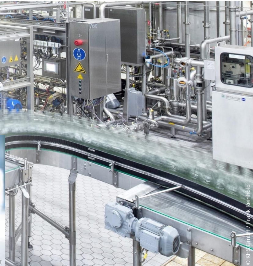
Prozessautomatisierung (verfahrenstechn. Anlagen)
