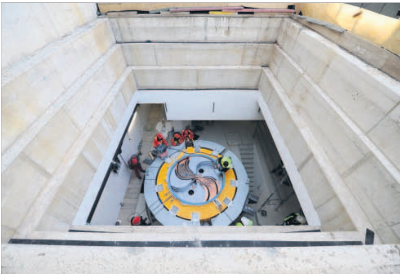
Blick auf das Herzstück der Protonentherapieanlage: Beim unteren Teil des Zyklotrons ist gut zu sehen, welchen Weg die Protonen bei der Beschleunigung in den vier kupfernen Bahnen nehmen. Foto:AndréWirsig
